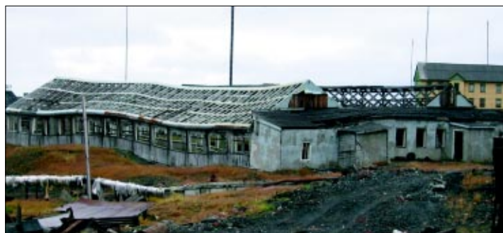
Abb.7: Durch Thermokarst verbogene Treibhausruine in Tiksi (sibirische Arktis). Foto: H. Lantuit (AWI-Potsdam).
